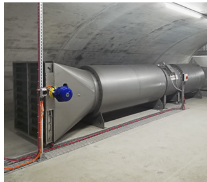
Die Lüftung im Notausstieg erzeugt im Ereignisfall einen Überdruck, damit der Rauch im Tunnel bleibt.
