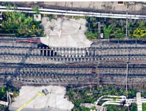
Die Gleise haben sich abgesenkt: Wegen eines Unfalls bei der Baustelle des Rastatt-Tunnels war die Rheintalstrecke während Monaten gesperrt.
