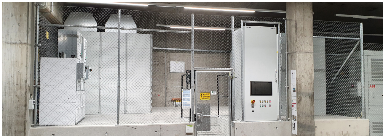
Installation de contrôle multitension à Spiez
