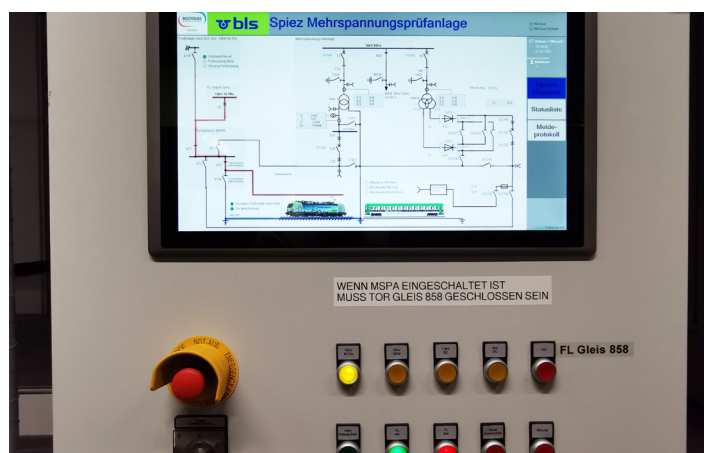
L'installation de contrôle multitension à l'œuvre
