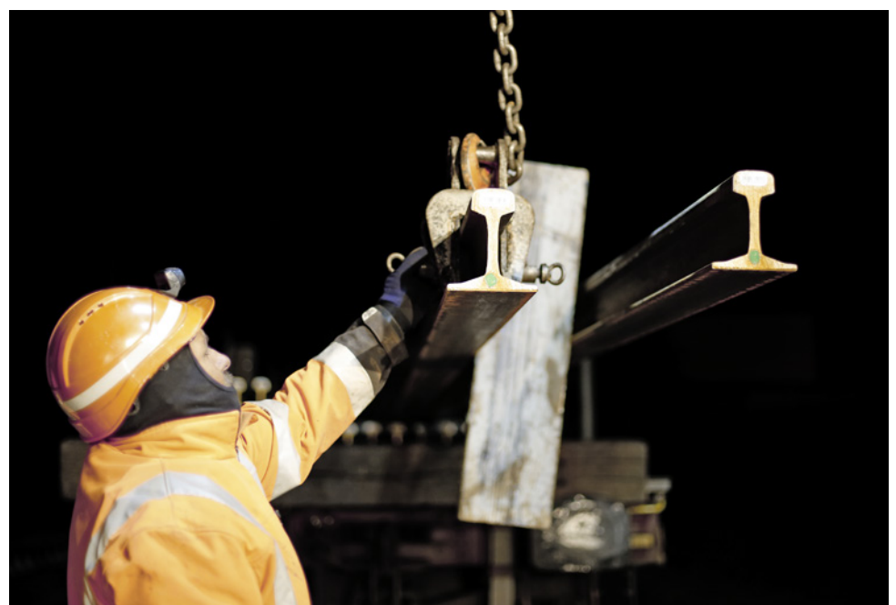
Die Stahlschienen werden vom Bahnwagen abgeladen und für den Einzug in den Tunnel bereit gelegt.
