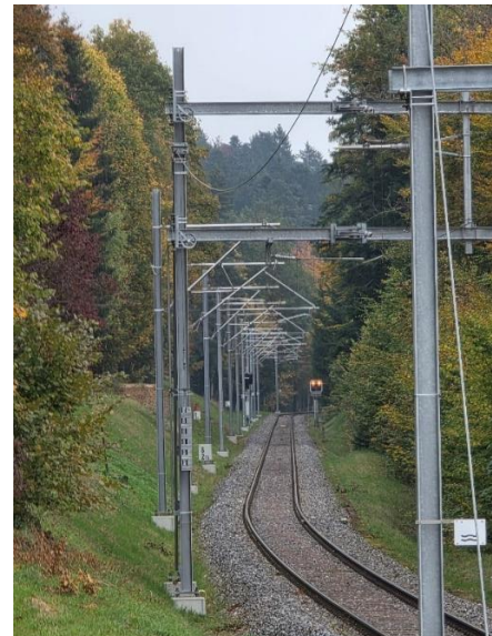
Abbildung 6: Neue Fahrleitungsanlage zwischen Lommiswil - Oberdorf
