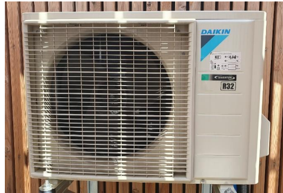
Abbildung 10: Klimagerät Technikraum Heimberg
