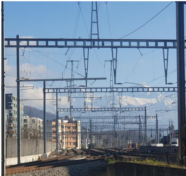
Abbildung 5: Fahrleitungsanlage Bahnhof Thun
